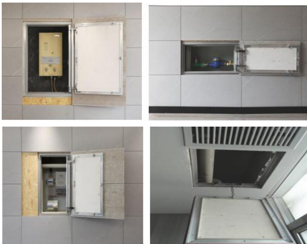
图6. 分水器、水表箱、电表箱、空调检修口
