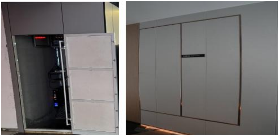
图4. 消防栓、强弱电间、电控室、空调机房
